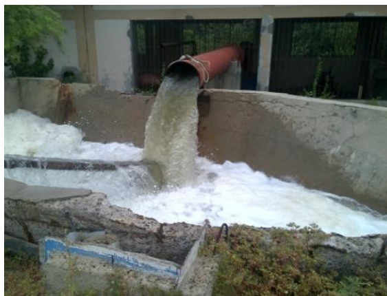
Figura 3. Estación de bombeo de la Facultad de Ingeniería Pesquera y Ciencias del Mar.
