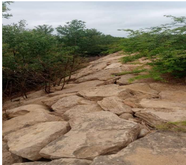
Figura 79: Punto inicial - Inicio de dique deteriorado
