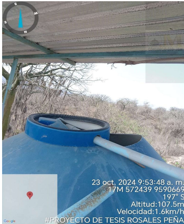
Imagen 2. Cortes en los tanques de almacenamiento.
