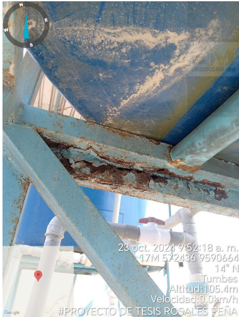
Imagen 12. Estructura de soporte con signos de corrosión y oxidación.
