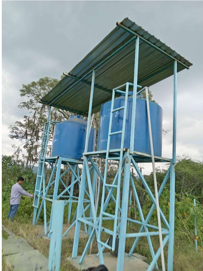
Imagen 9. Tanques en operación del sistema de almacenamiento del centro poblado Chacritas 2024.
