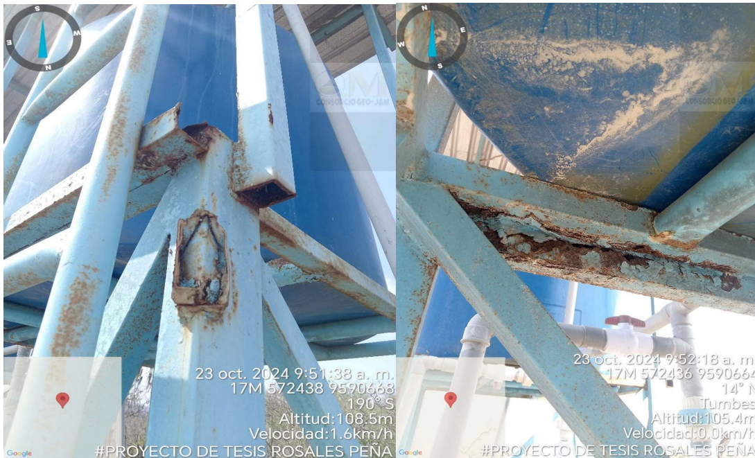
Imagen 3. Soporte de estructura de tanque de polietileno.
