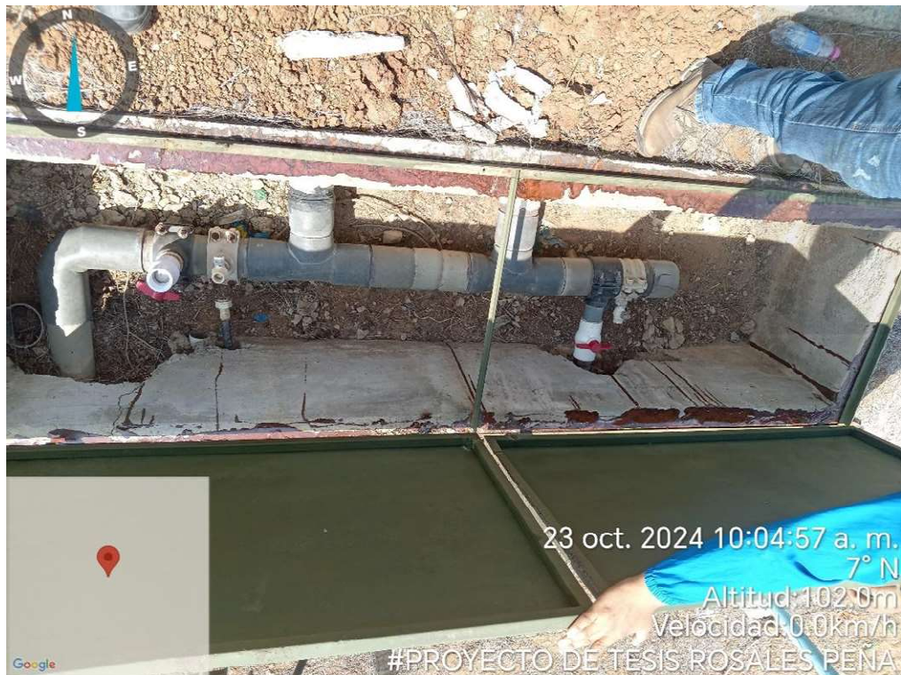
Imagen 10. Panel de distribución del centro poblado Chacritas.
