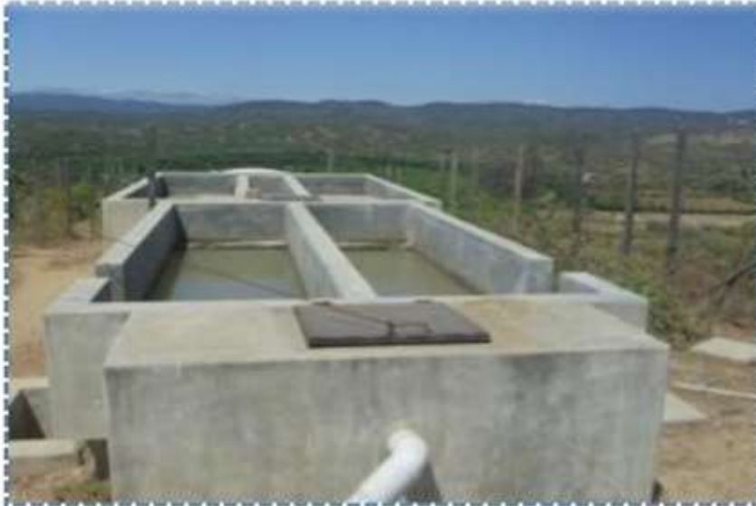
Foto N°12: POZA DE TRATAMIENTO RICA PLAYA
