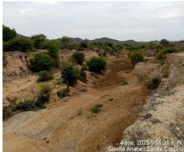
Foto N.º 10. Socavones existentes generados por la extracción de material de acarreo 4 ene. 2025 9:51:31 a. m. Gisella Anabeli Zárate Castillo
