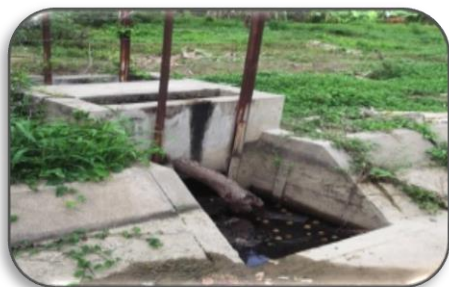
Foto 39: lateral N° 09, de la infraestructura hidráulica de riego de Casa Blanqueada.
