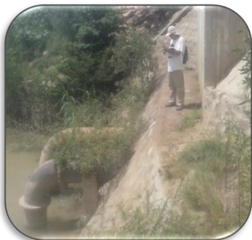
FOTO 103: Tuberías de succión de la infraestructura de riego de Oidor.
