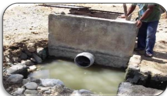
Foto 55: poza de descarga de la infraestructura hidráulica de riego de Rica Playa.
