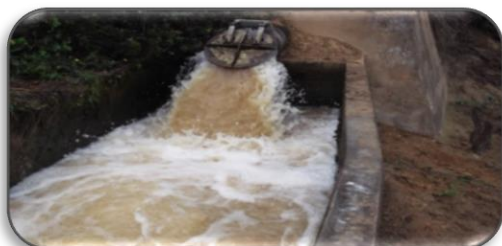
Foto 11: tubería de impulsión de hierro de 16 pulgada de la infraestructura hidráulica de riego Oidor.
