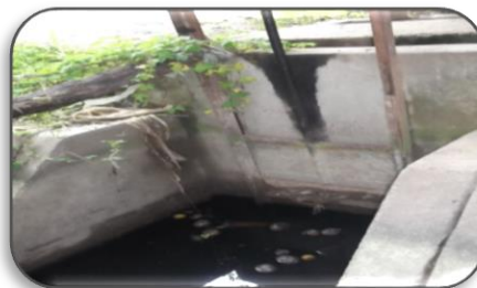
Foto 36: lateral N° 06, de la infraestructura hidráulica de riego de Casa Blanqueada.
