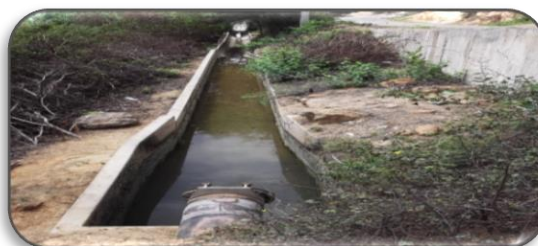
Foto 12: poza de descarga de la infraestructura hidráulica de riego Oidor.
