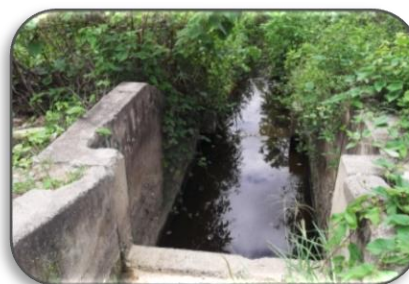
Foto 34: caída N° 02, del lateral N° 04, de la infraestructura hidráulica de riego de Casa Blanqueada.
