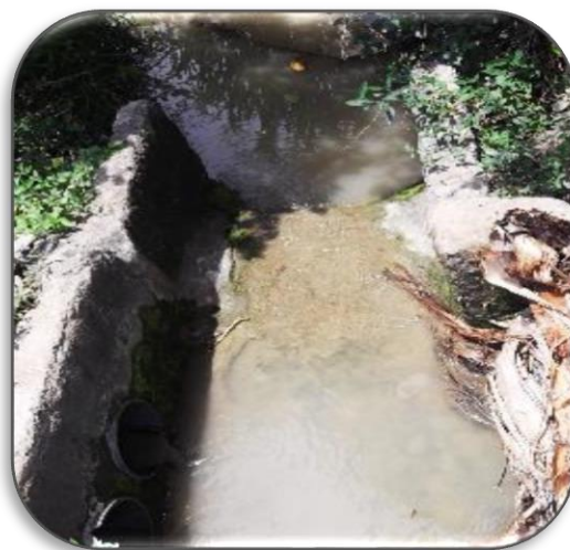
Foto 22: lateral N° 02 de la infraestructura hidráulica de riego de Rica Playa.
