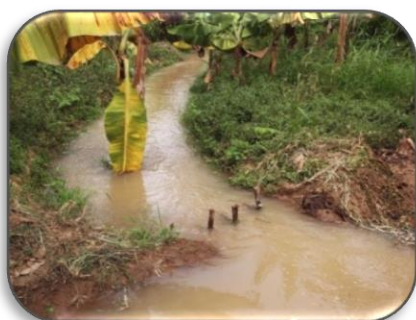
Foto 61: toma de tierra, materiales rústicos, lateral N° 04, de la infraestructura hidráulica de riego de Oidor.
