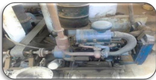
Foto 07: electrobomba hidrostal de 50 hp de la infraestructura hidráulica de riego Higuierón.
