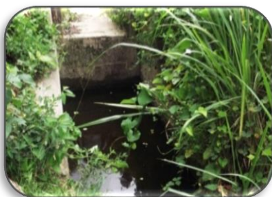
Foto 33: caída del lateral N° 04, de la infraestructura hidráulica de riego de Casa Blanqueada.
