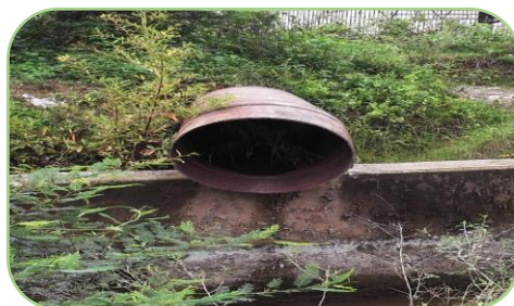
Foto 76: tubería de impulsión infraestructura hidráulica de riego de Casa Blanqueada.
