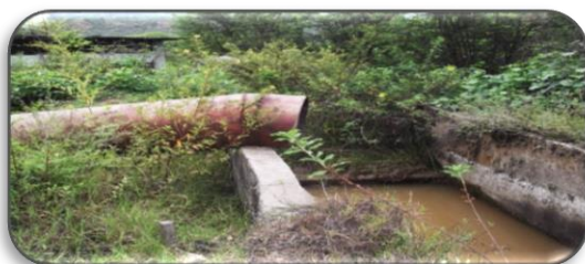
Foto 09: tubería de impulsión de la infraestructura hidráulica de riego de Casa Blanqueada.
