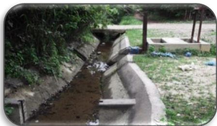
Foto 35: lateral N° 05, de la infraestructura hidráulica de riego de Casa Blanqueada.
