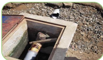
Foto 89 sistema de control de la infraestructura hidráulica de riego de Rica Playa.
