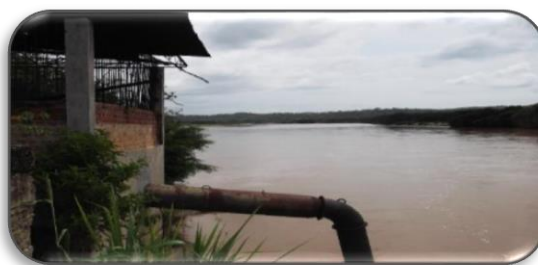
Foto 08: la caseta de bombeo y la tubería de succión de la infraestructura hidráulica de riego Casa Blanqueada.
