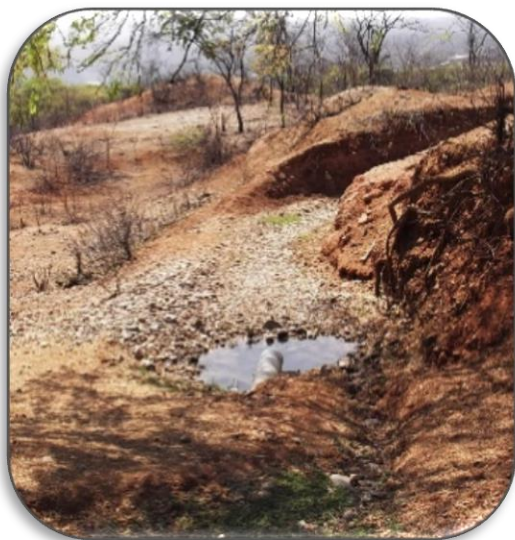
Foto 27: lateral N° 7 de la infraestructura hidráulica de riego de Rica Playa.
