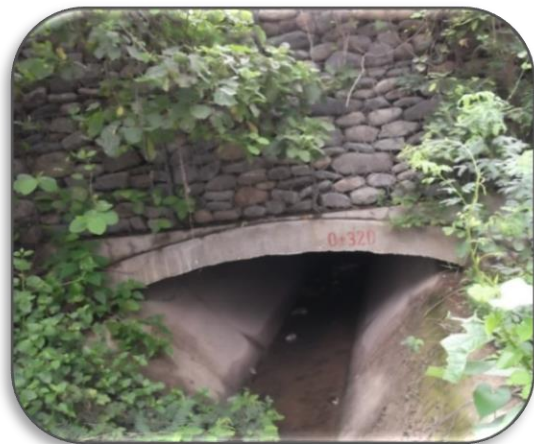
Foto 16: al inicio y al final del conducto se encuentran montados muros de gaviones, de la infraestructura hidráulica de riego Casa Blanqueada.
