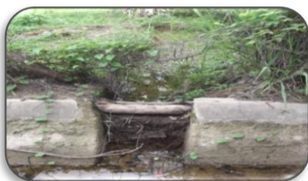
Foto 37: lateral N° 07, de la infraestructura hidráulica de riego de Casa Blanqueada.
