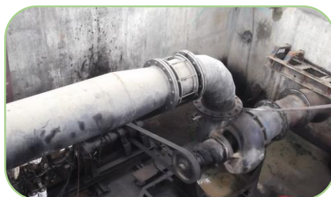
Foto 74: caseta de bombeo de la infraestructura hidráulica de riego de Casa Blanqueada.
