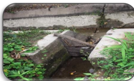
Foto 38: lateral N° 08, de la infraestructura hidráulica de riego de Casa Blanqueada.
