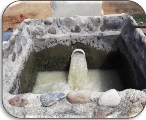
Foto 13: tubería de impulsión de la infraestructura hidráulica de riego de Rica Playa.
