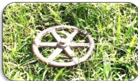
Foto 54: válvula N° 03, de la infraestructura hidráulica de riego de Rica Playa.
