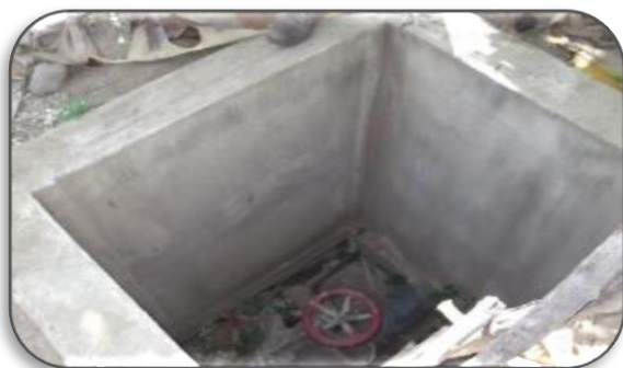
Foto 53: válvula N° 02, de la infraestructura hidráulica de riego de Rica Playa.
