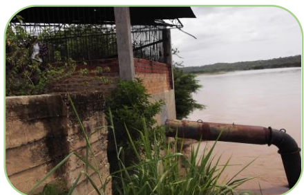
Foto 75: tubería de succión de la infraestructura hidráulica de riego de Casa Blanqueada.
