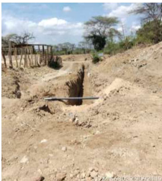
Figura 54: Tubería enterrada tramo 1 – Lateral 12
