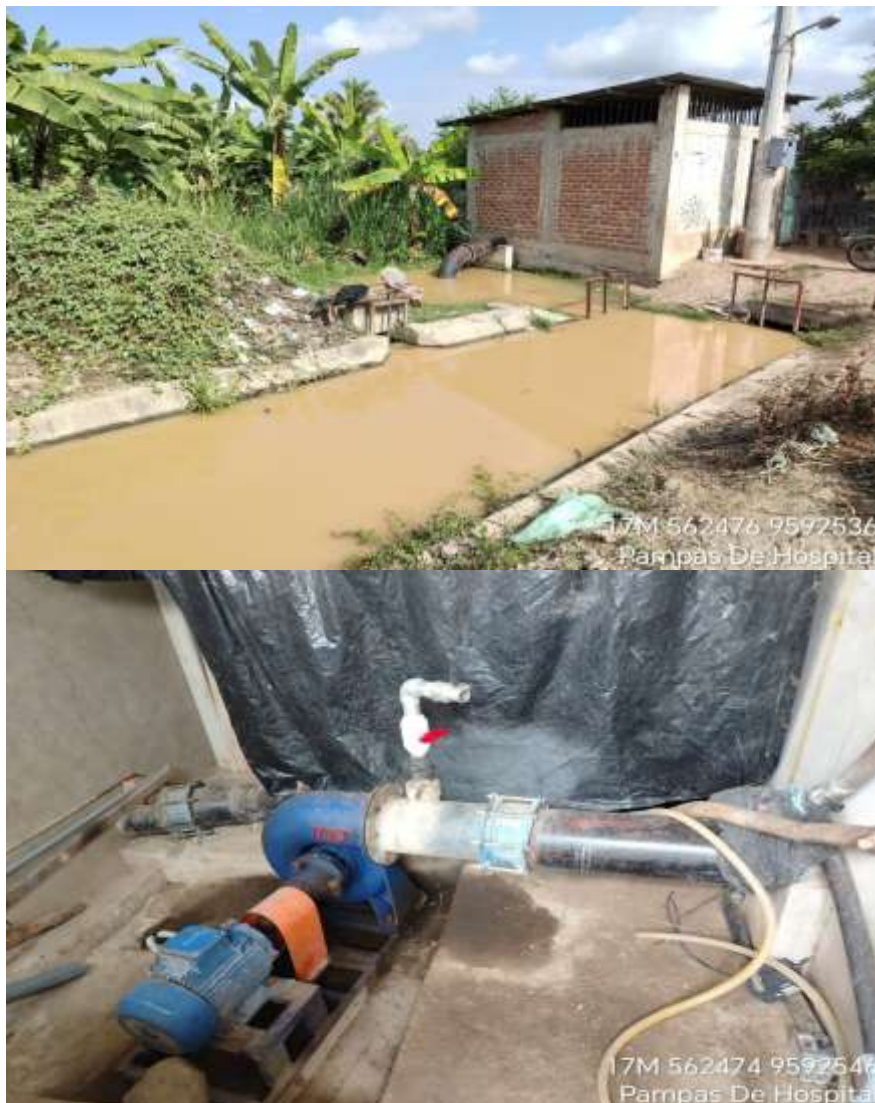
Figura 11, Estación de rebombeo
