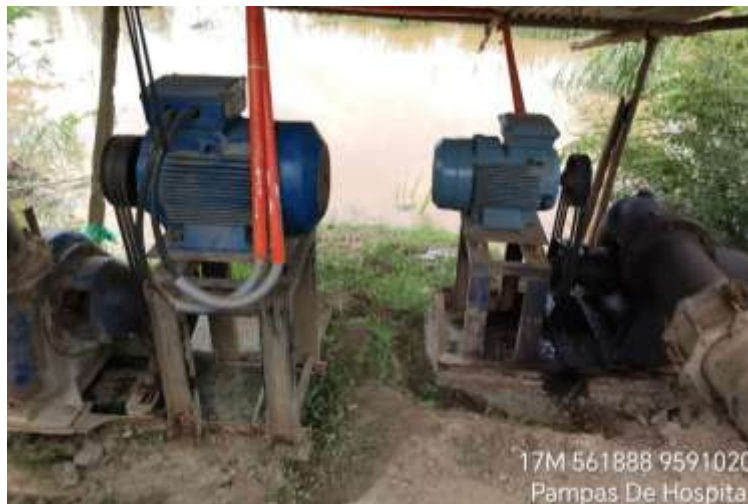
Figura 6, Bombas y Motores
