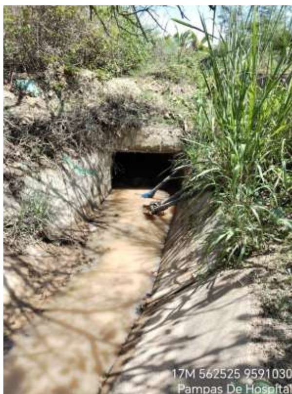
Figura 59: Entrada del Sifón Invertido
