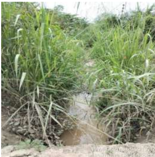
Figura 35: Densa maleza tramo 1 – Lateral 5
