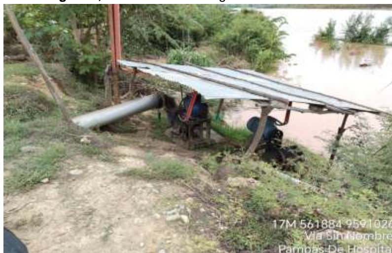
Figura 8, Tuberías de descarga
