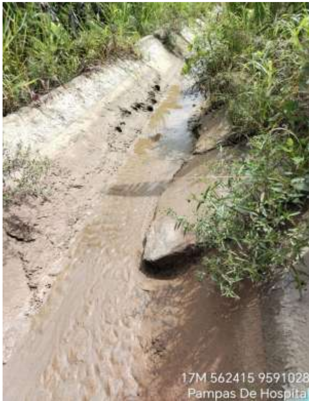
Figura 17: Evidencia dos - tramo 03
