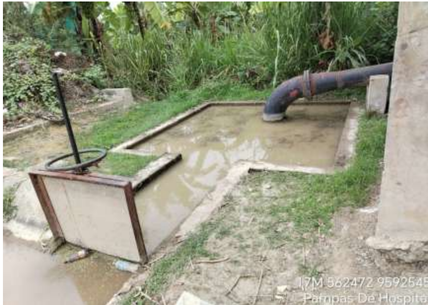
Figura 12, Poza de succión de la estación de rebombeo
