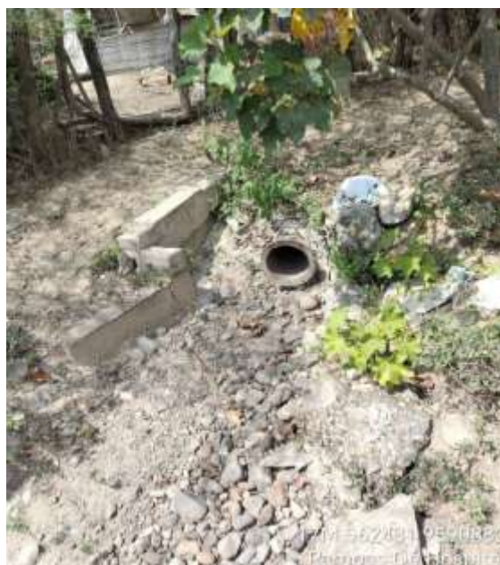
Figura 55: Fin de tubería tramo 1 – Lateral 12
