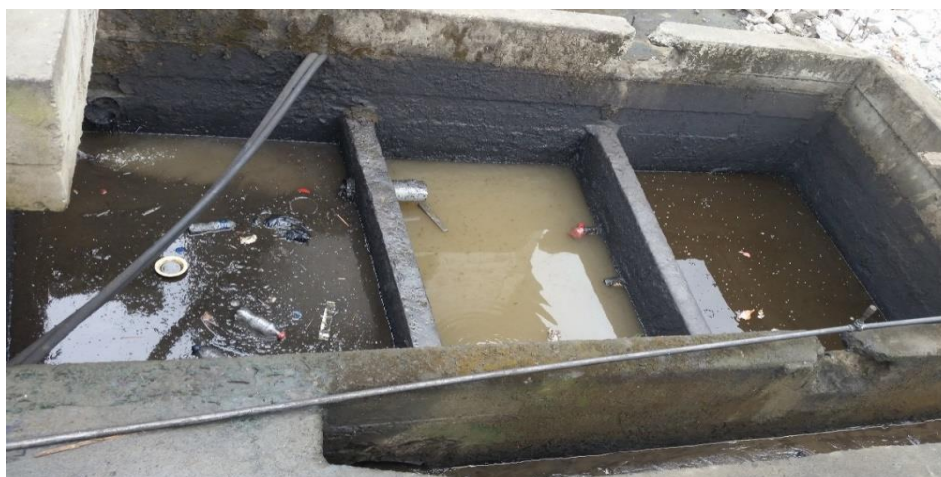
Figura N° 4.4 No existen trampas de aceite.
