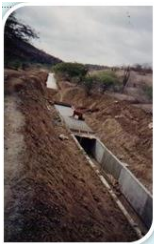
Foto N°10: Canal Tapado – Soporta Deslizamientos
