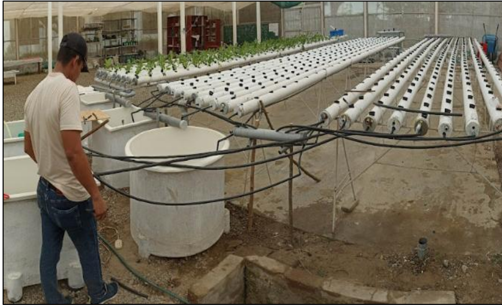
Figura 14. Instalación del sistema NFT.
