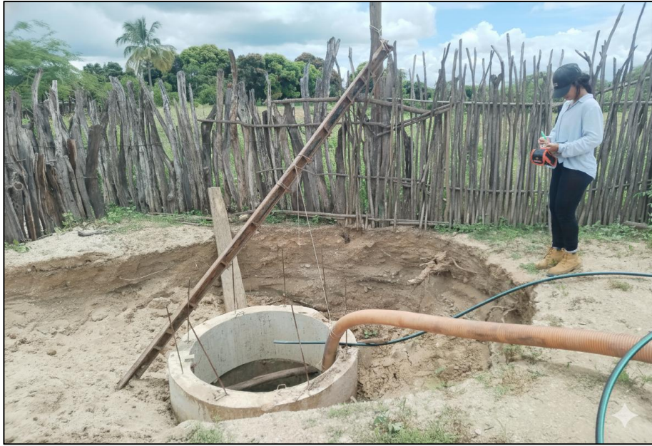
Figura 57: Pozo anillado tajo abierto existente y en funcionamiento.
