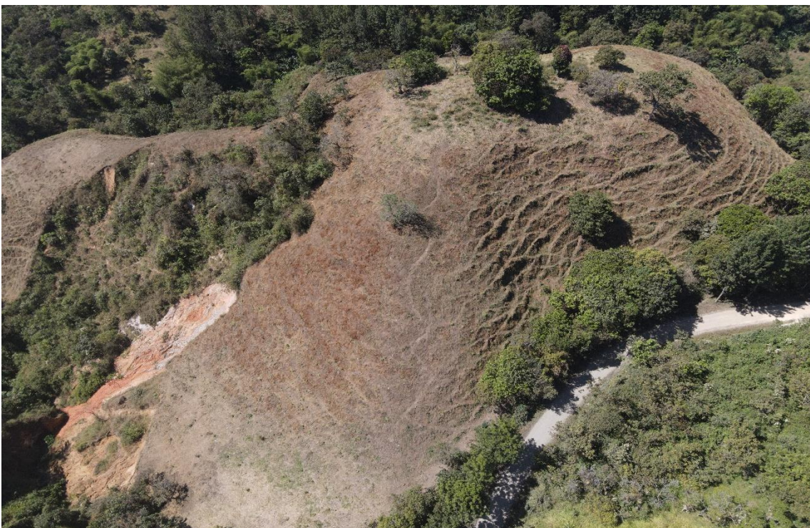
FOTO 2: EROSION DEL SUELO
