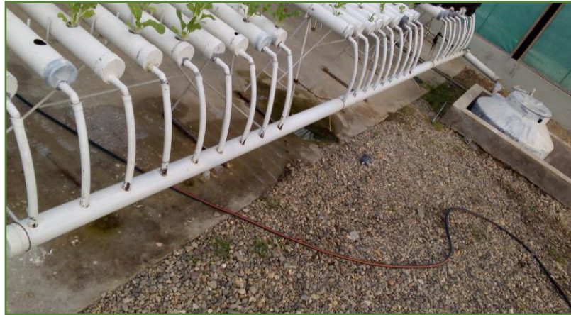
Figura 15. Tubería colectora en el sistema hidropónico NFT
