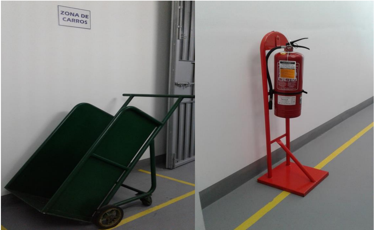
Fotografía 14 y 17: Almacén de Droguería de Gases Medicinales: Implementos indispensables.
