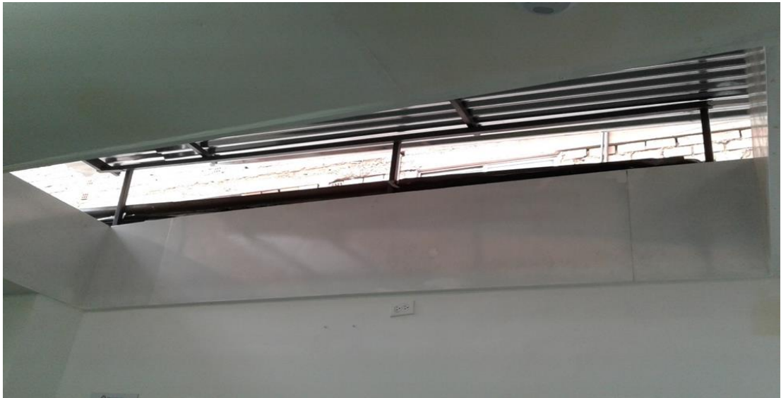
Fotografía 10, 11 y 12: Ventilación del Almacén de Droguería de Gases Medicinales
