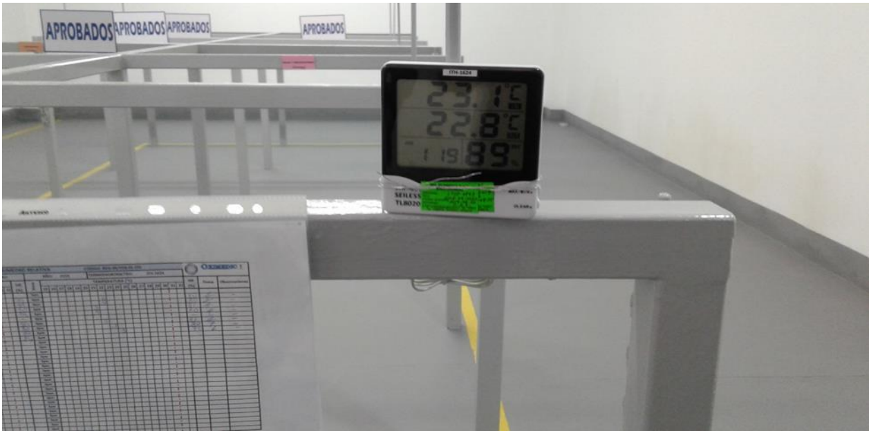
Fotografía 1: Almacén de Droguería de Gases Medicinales. control constante de temperatura (T) y humedad relativa (HR)
