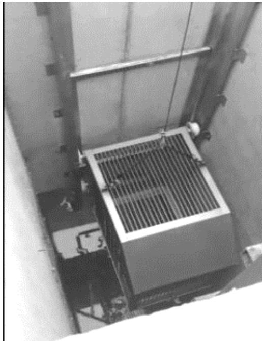
Figura 5 Filtros en canasto de retención de sólidos.
